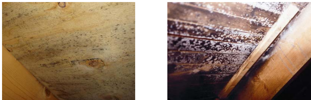
Figur 5.1 Bilderna visar olika grad av mögelpåväxt på yttertaketets inneryta, där den högra är värst drabbad (Ventotech, 2006).
